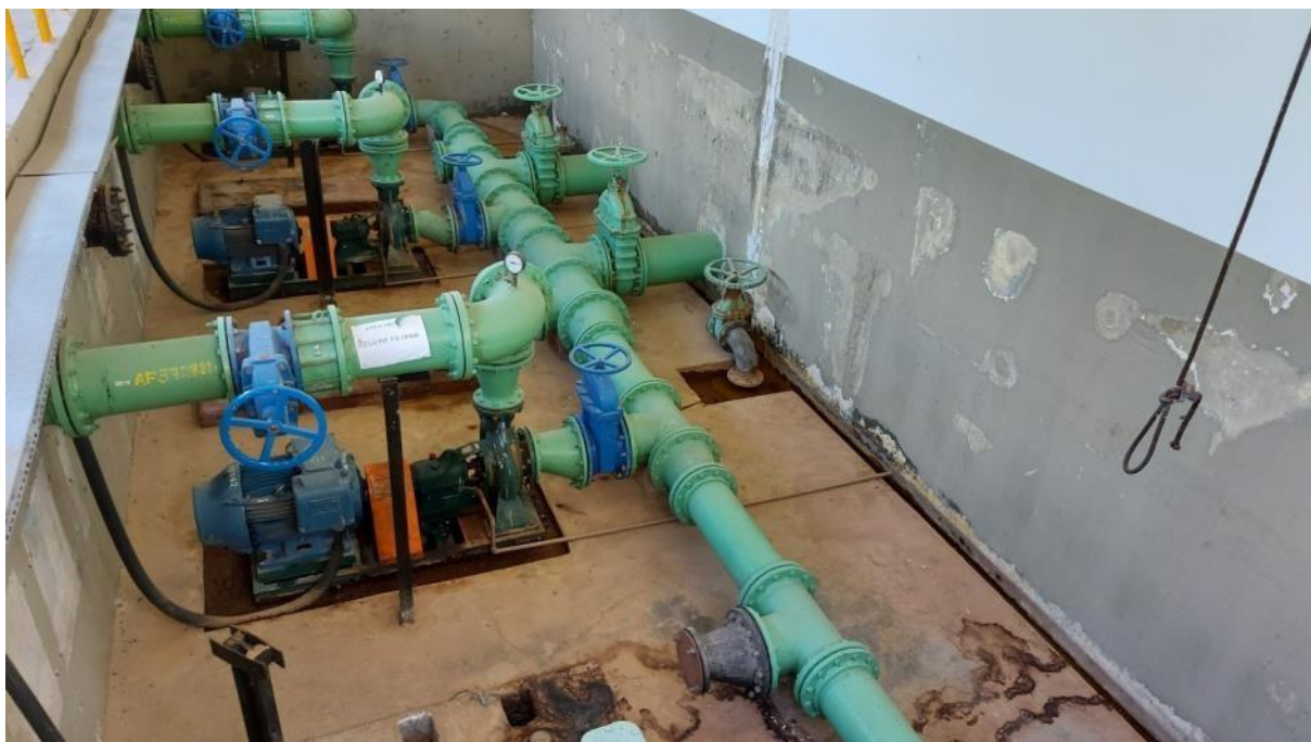
Figura 25 – ETA do Sistema Jatobá / Tacaratu (COMPESA) Fonte: Instituto Gesois, 2020.
