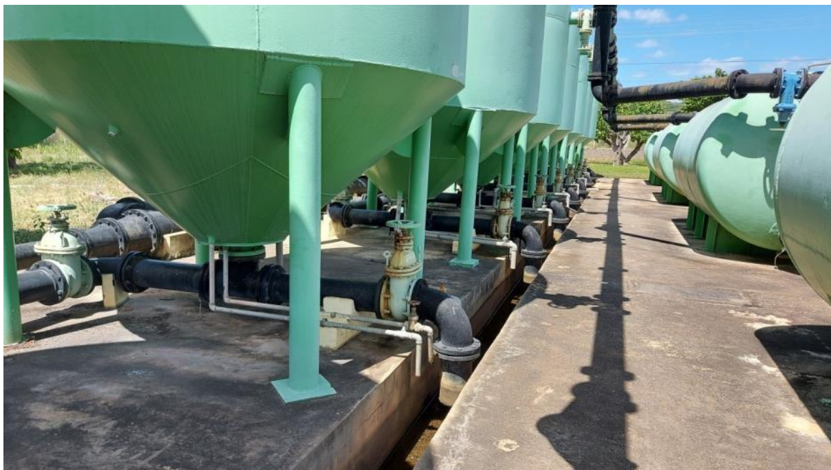
Figura 24 – ETA do Sistema Jatobá / Tacaratu (COMPESA) Fonte: Instituto Gesois, 2020.
